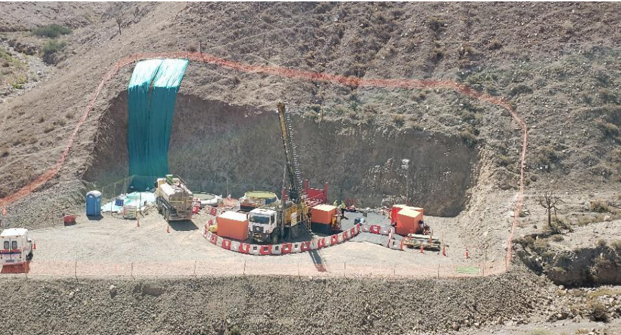
Ejemplo: Plataforma en operación
