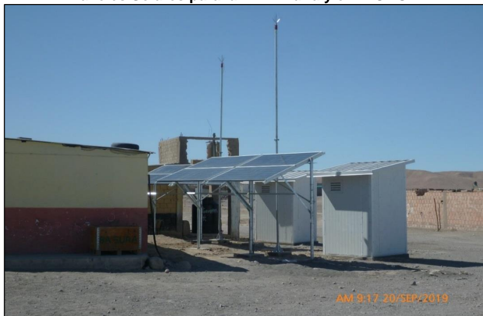
Fotografía N° 3. 30 Paneles Solares para la IE Primaria y el PRONOEI
