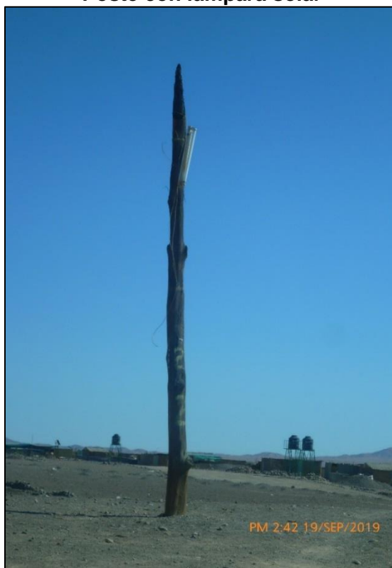
Fotografía N° 3. 29 Poste con lámpara solar
