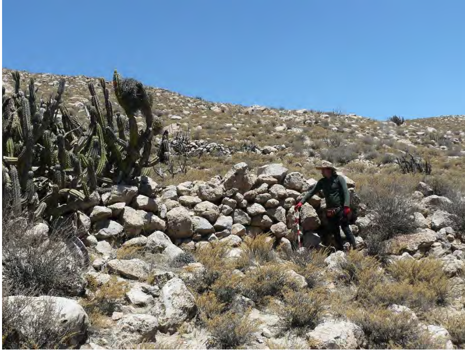
Foto 14.- Vista sur. Detalle referencial de altura de muro de contención de andén. Muchos de ellos actualmente se encuentran abandonados.
